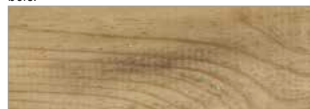
Enlever les taches de moisissure avec un nettoyeur à base de chlore
