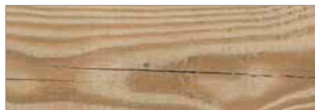
Fissures de contrainte (conformes à la norme DIN)
