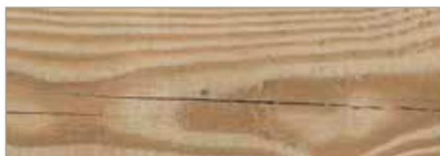
Spanningsscheuren (volgens DIN norm)
